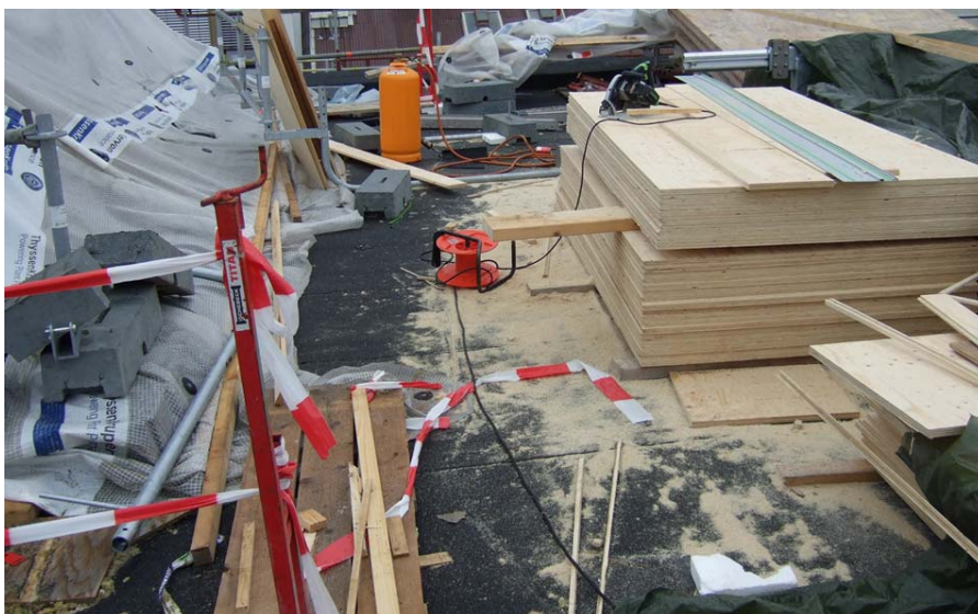
Figur 2: På byggeplasser der det er trangt om plassen må man sørge for nødvendige beskyttelsestiltak og ryddighet gjennom god planlegging. Bildet viser ikke et eksempel til etterfølgelse.
