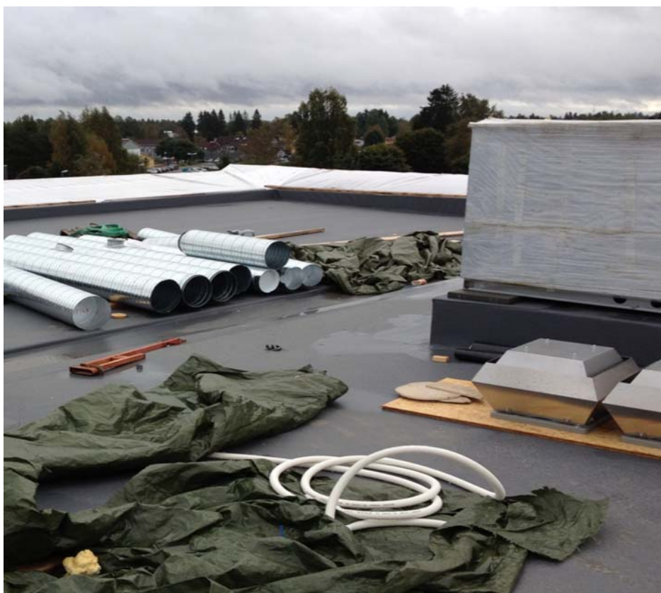
Figur 1: Tak benyttes ofte som lagringsplass i byggefasen, noe som medfører risiko for mekaniske skader.
